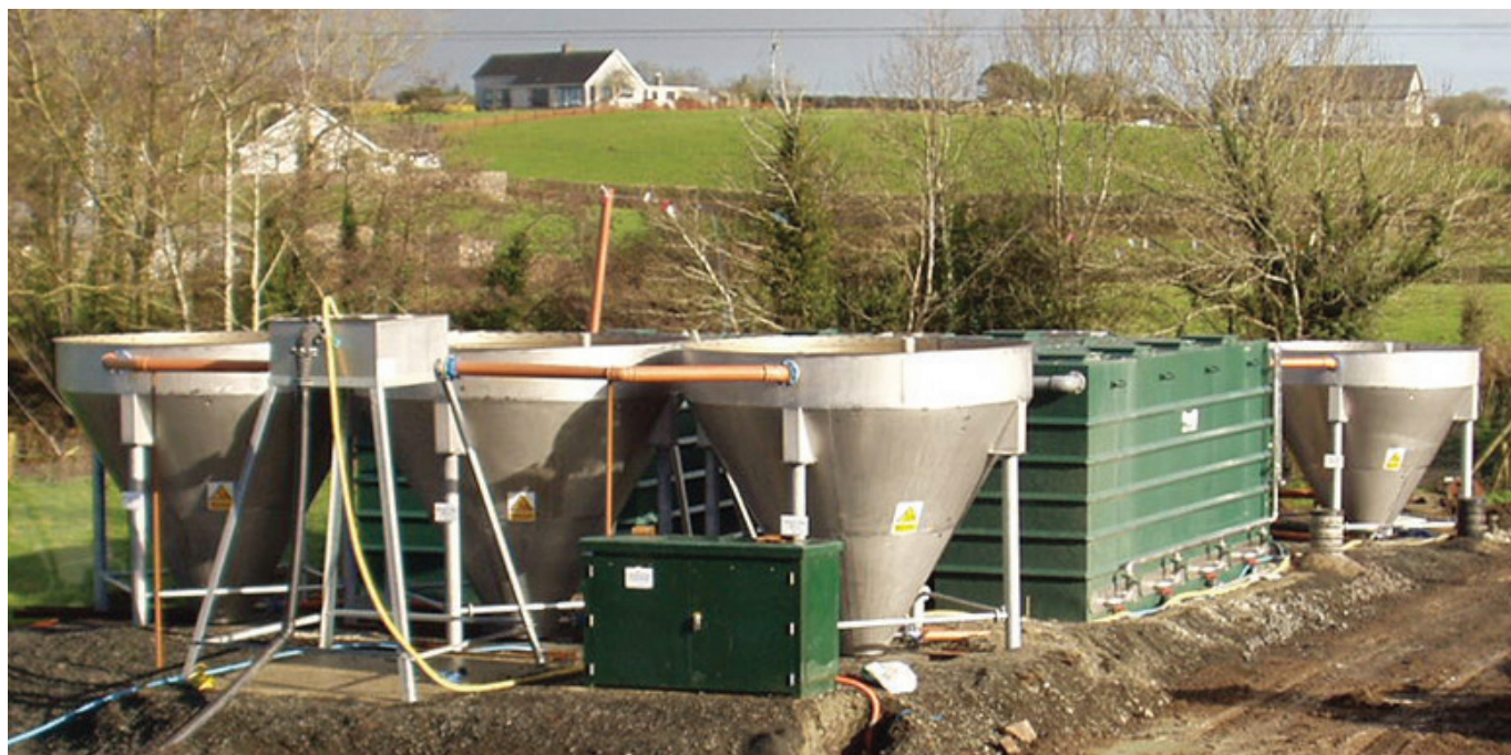
Jacopa 2000 PE SAF Plant.
